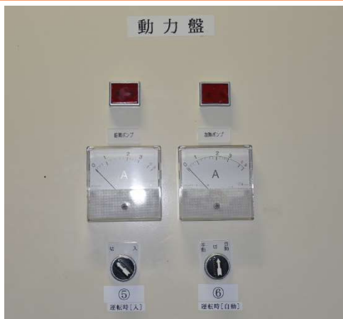
動力盤表面パネル
